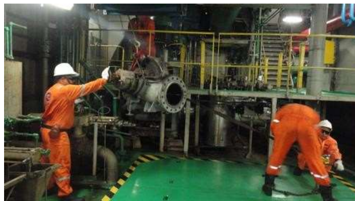
Figura 3 - Los usuarios tiran de la bomba con el tirfor para pasar a través de las interferencias
